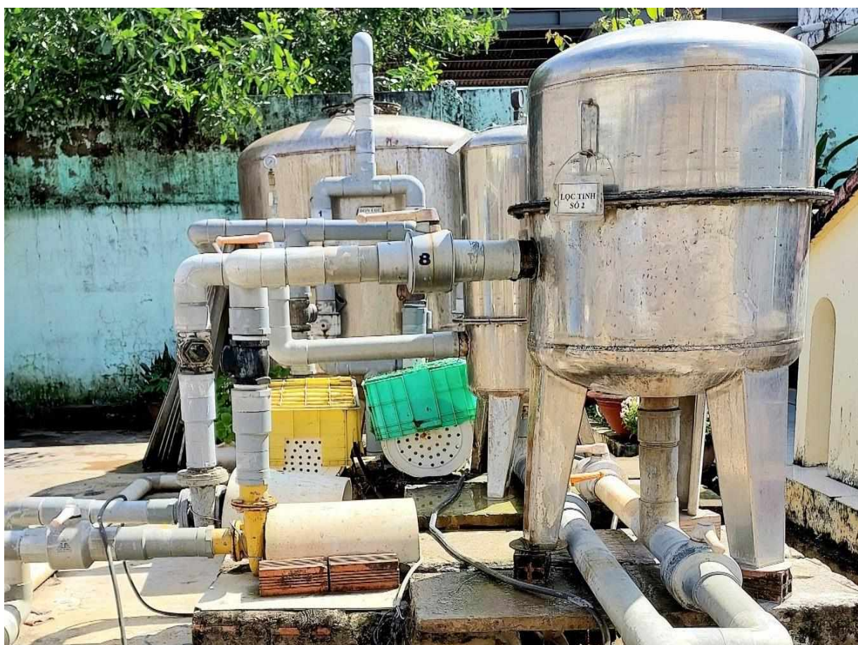
Hình 1.7: Hệ thống lọc nước tại cơ sở
