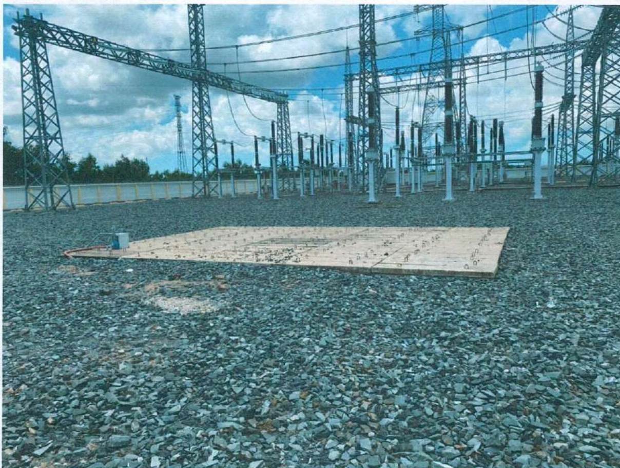
Hình 3.6: Bể dầu sự cố tại cơ sở
