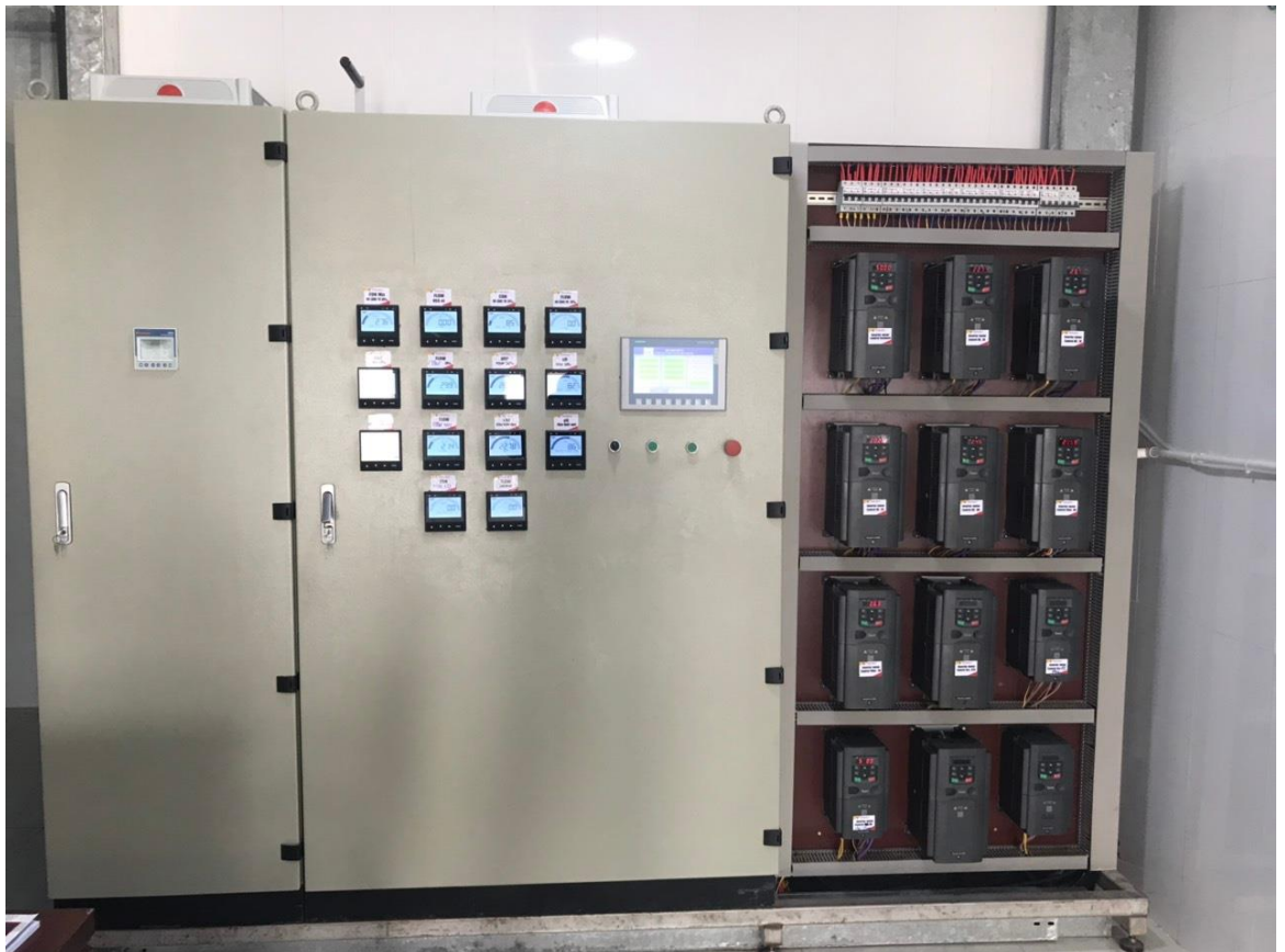
Hình 2.7. Hệ thống biến tần GD 200A của hệ thống xử lý nước.
