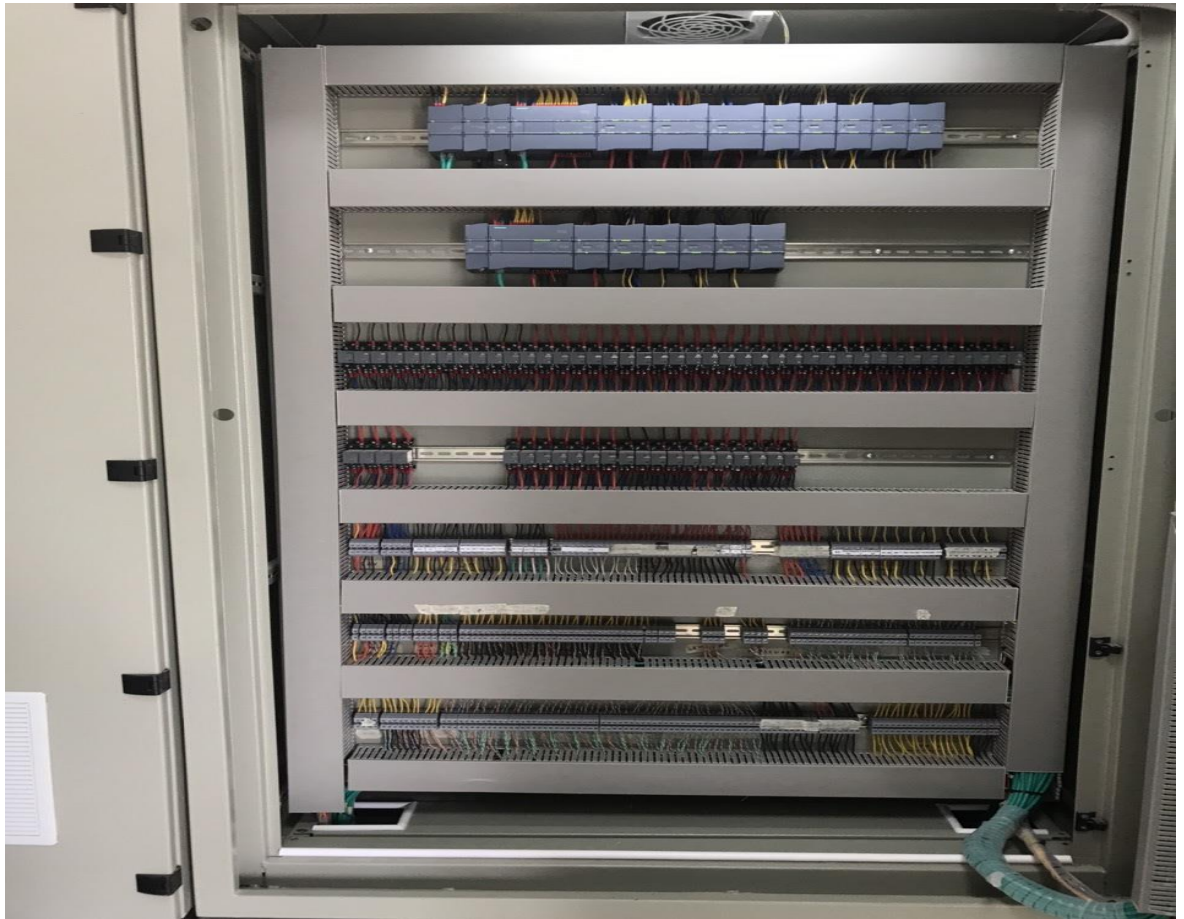
Hình 2.6. Tủ điều khiển PLC S7 – 1200 Siemens của hệ thống xử lý nước.
