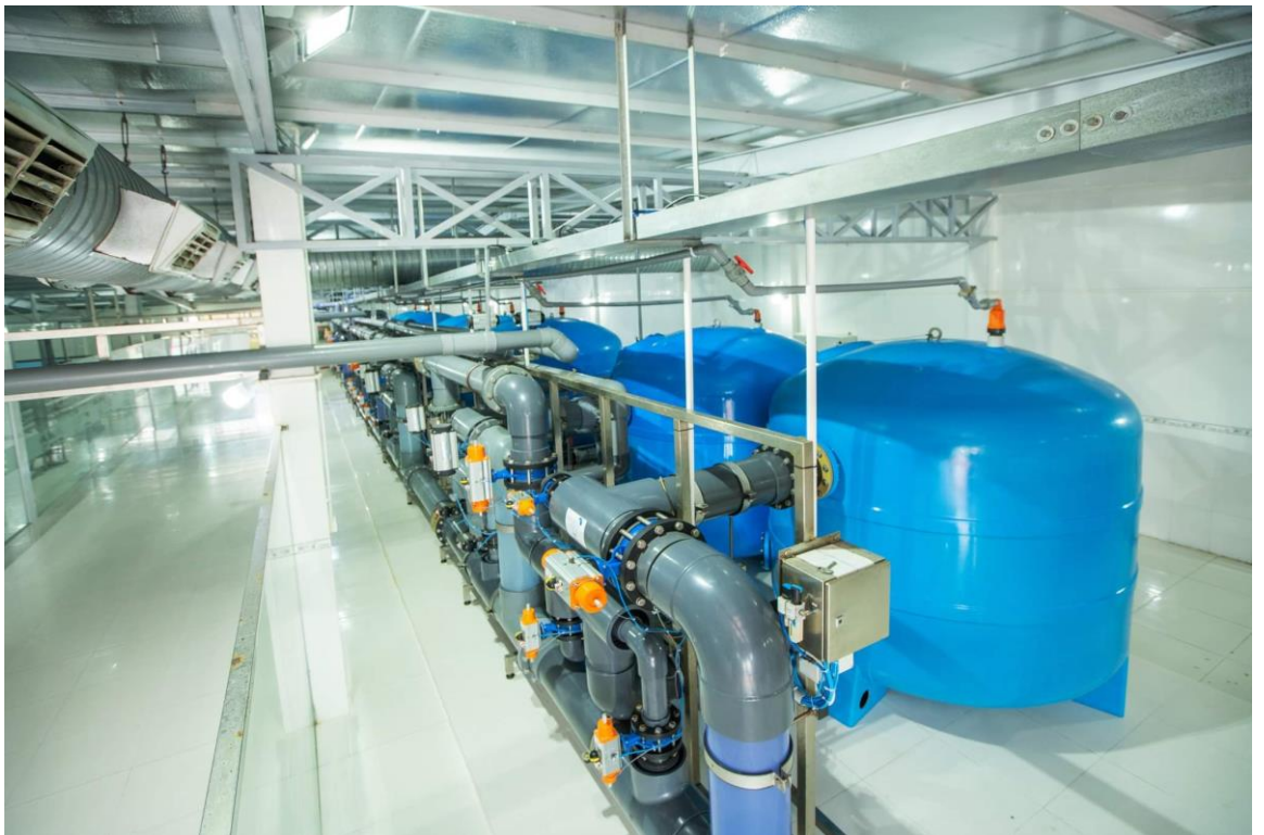
Hình 2.3. Hệ thống bồn lọc nước
